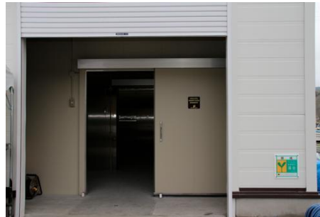
水揚げした魚類を鮮度を保ったまま急速冷凍をするCAS機能冷凍保管庫
