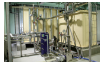
復旧した洋野町営八木市場。汲み上げた海水を濾過・冷却・殺菌し市場内に送る海水冷却装置と断熱貯水タンク（写真下）
