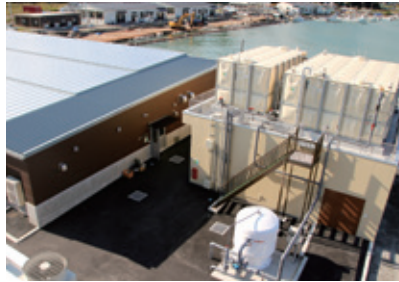
宮城県漁業協同組合 七ヶ浜町水産振興センター建設事業
