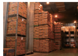
修復した大船渡湾冷凍水産加工業協同組合の永沢冷蔵庫
