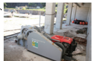
電気がなくても動かせるエンジン式（写真）を含む計4台の巻揚げ機を導入（普代村堀内漁港）
