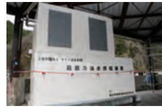
殺菌冷海水供給装置
